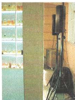
Foto 9: Lautsprecher ITEC im Foyer des Theater im Palais
